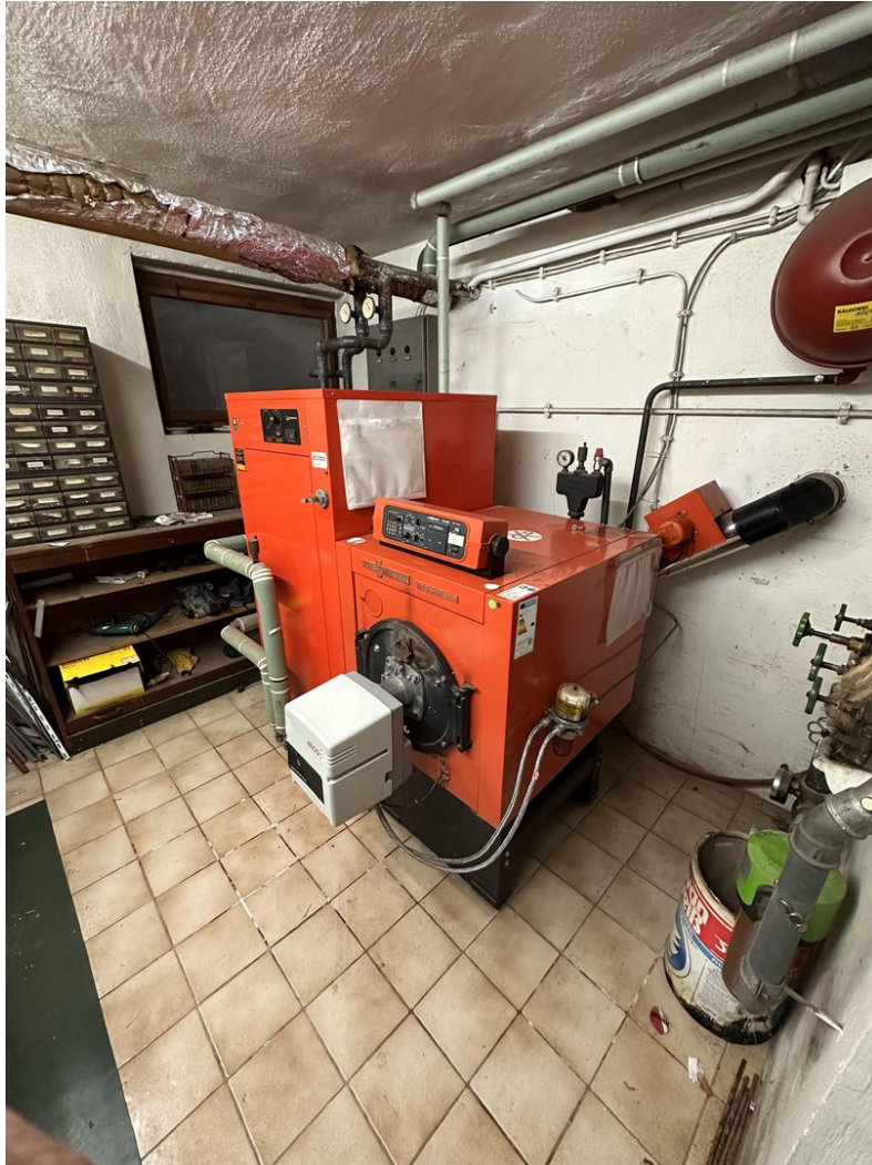
Ölheizung im Keller
