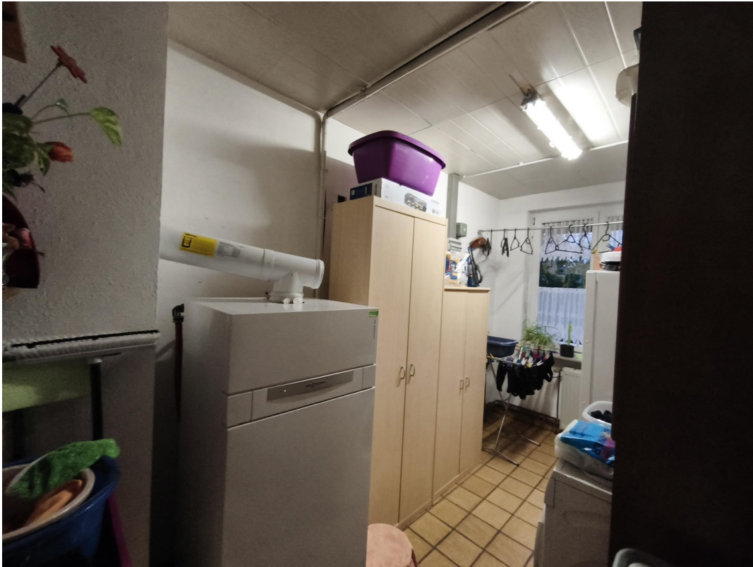
HWR mit Gasbrennwertheizung
