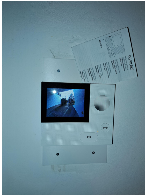
Gegensprechanlage in Wohnung
