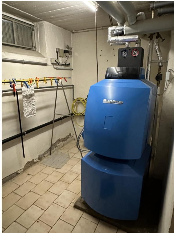
Haustechnik Heizungsraum UG
