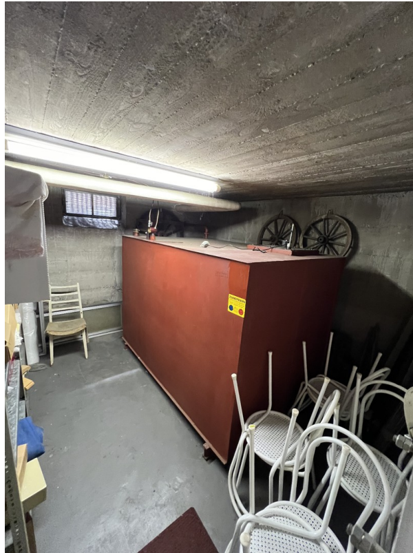
Haustechnik Tankraum UG
