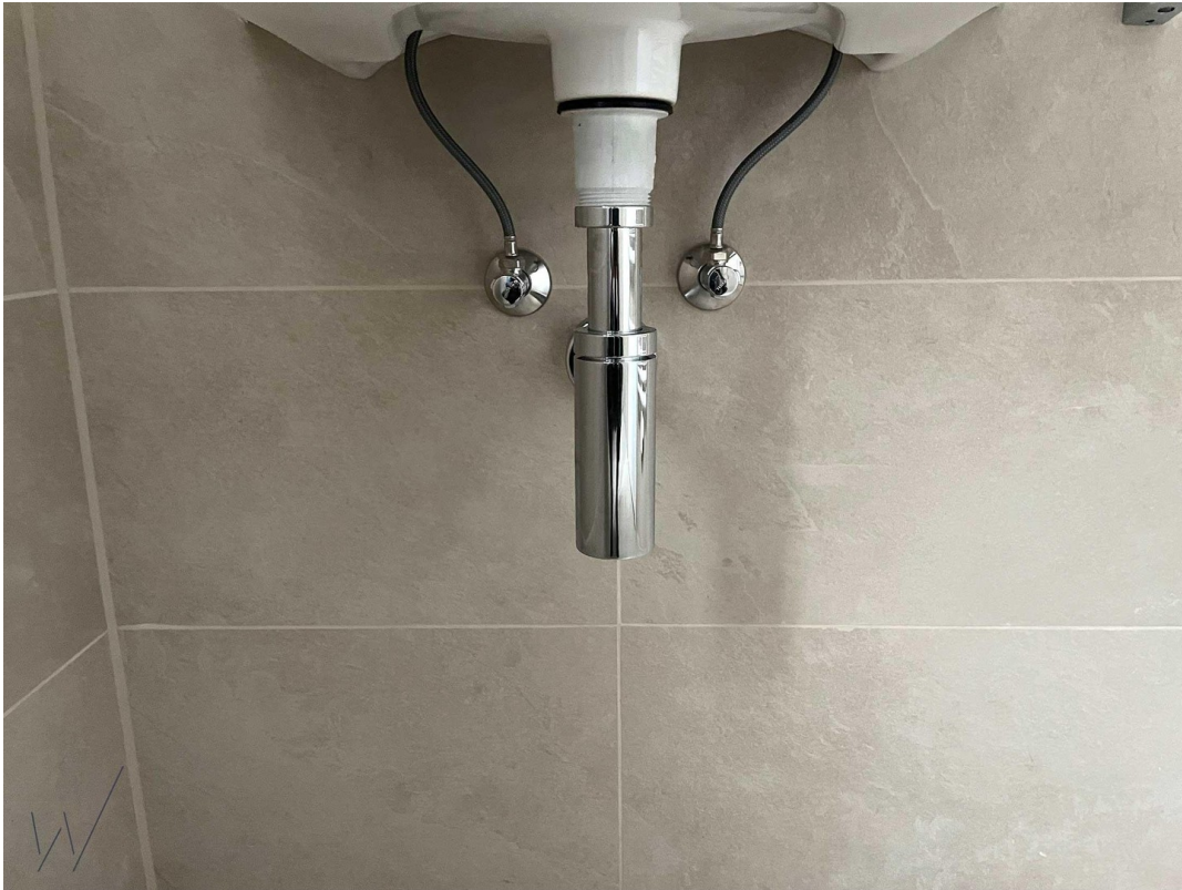
Designsiphon in allen Bädern
