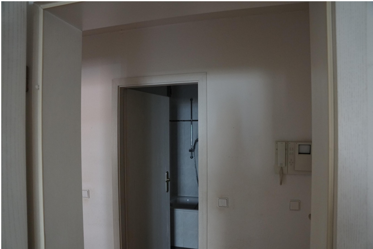
Videosprechanlage in Diele
