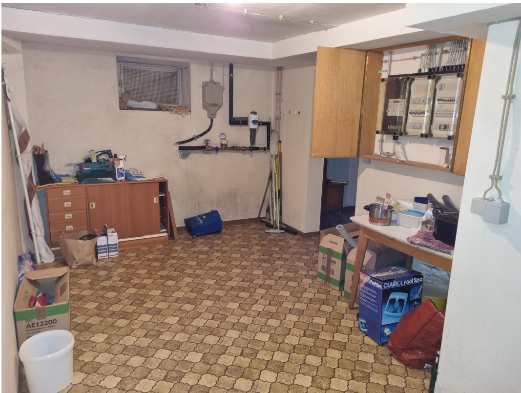
Keller Strom Wasser
