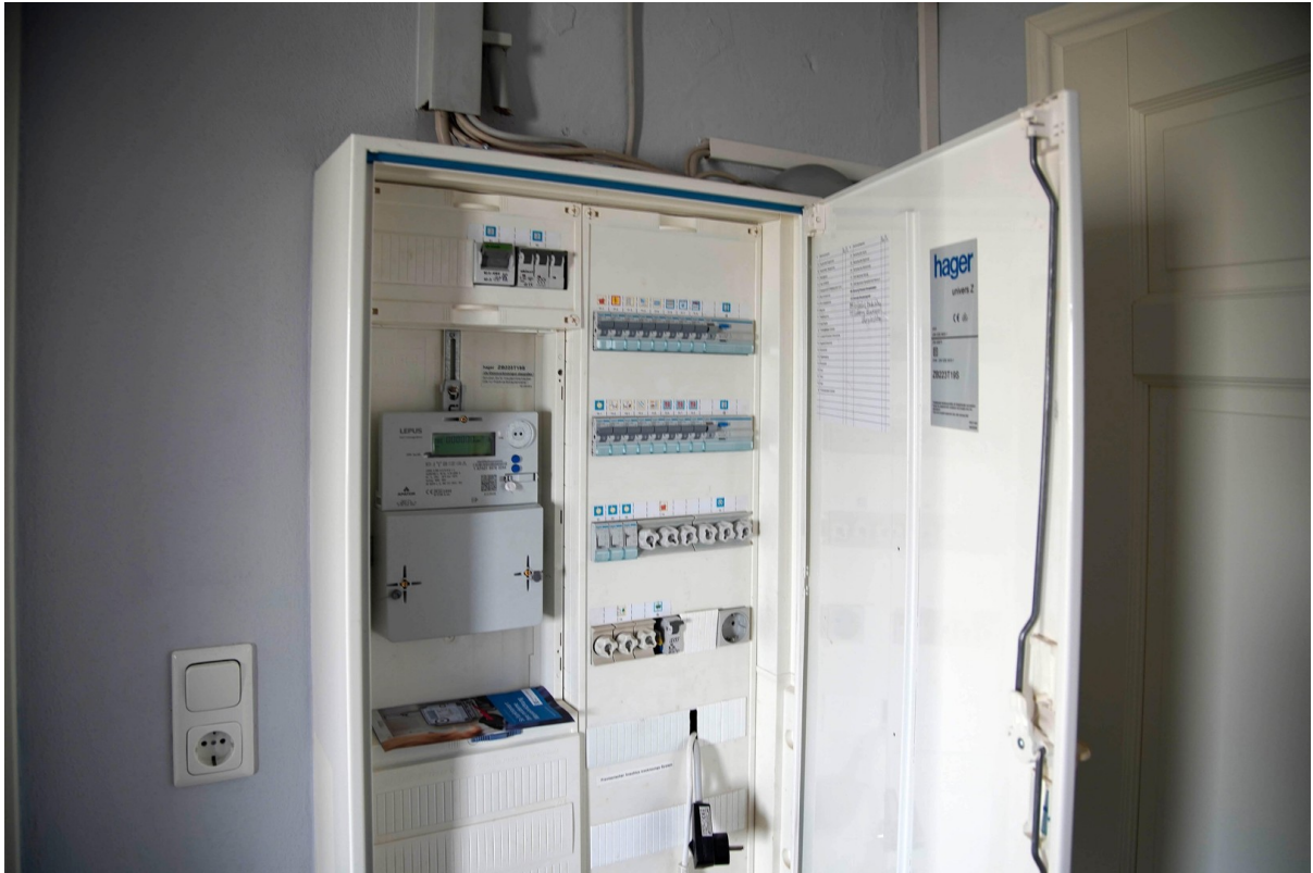
Elektrik auf aktuellem Stand
