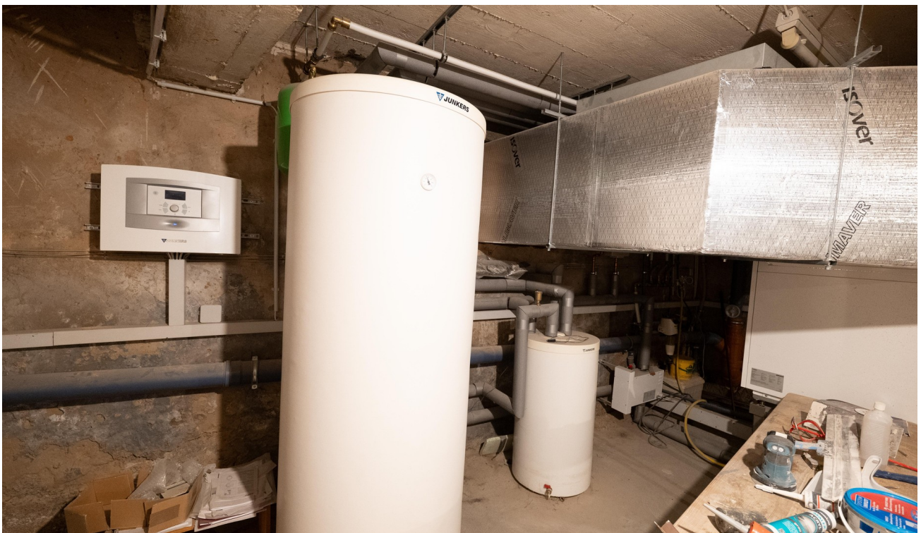
Wärmepumpe mit Speicher
