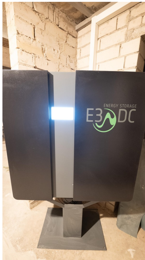
PV Speicher 6,5 kW
