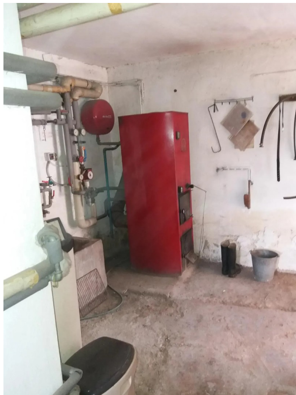
Heizraum und Waschküche
