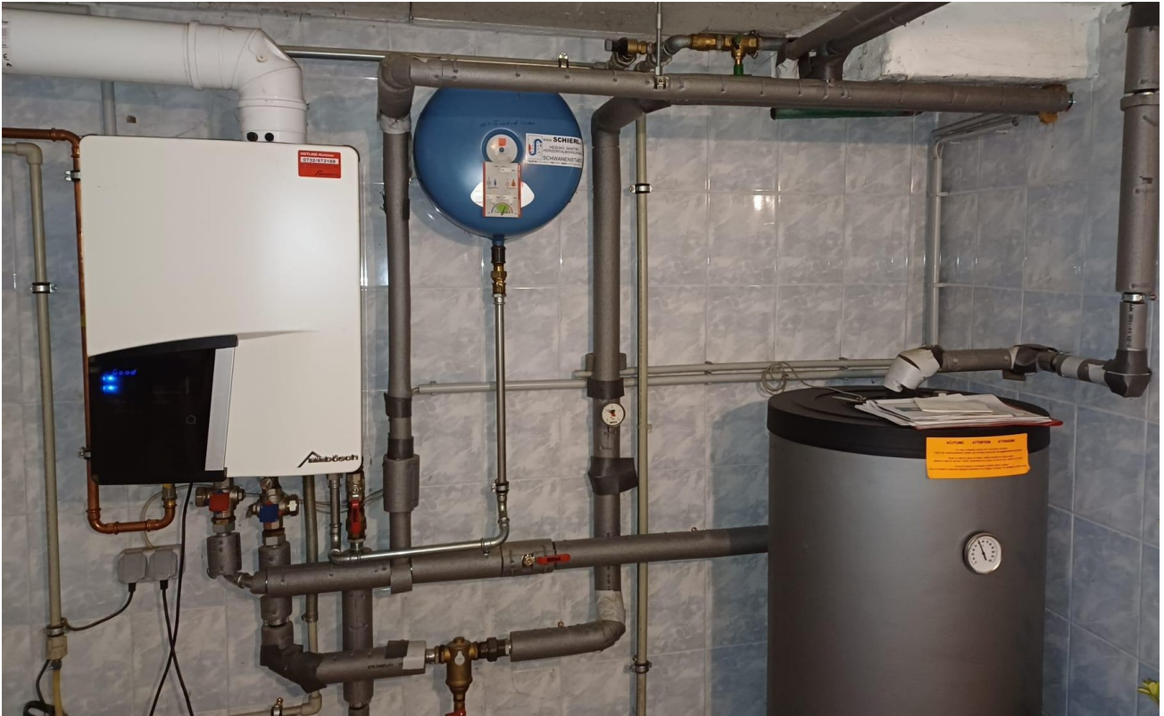
Gastherme u. Boiler im Keller
